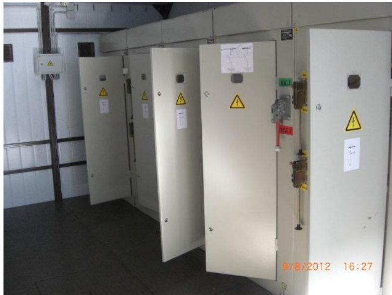
Фото 1. Распредустройство 10 кВ с установленными КСО-393
