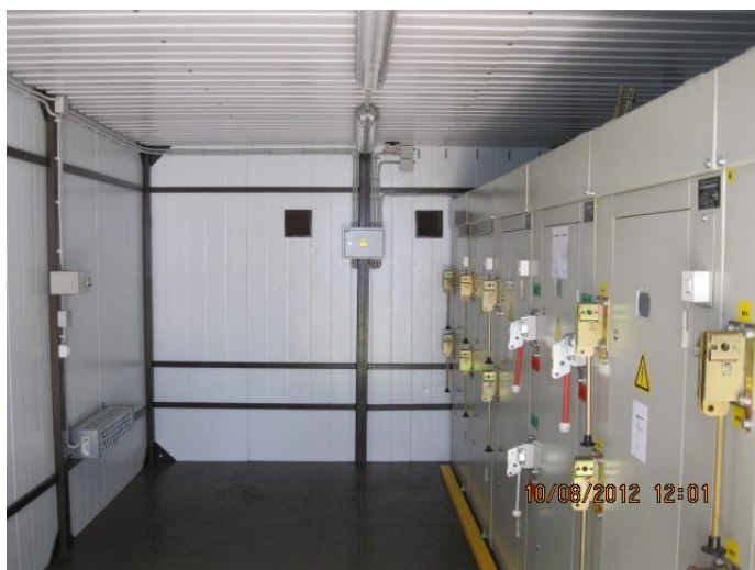
Фото 7. Распредустройство 10 кВ в 2КТПНУ-1000 ООО «ФорумТверь», ТПЗ Боровлёво, г.Тверь
