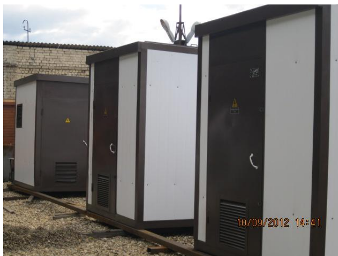
Фото 1. 2КТПНУ-1000, утеплённая для ООО «ИнженерЭлектроСтрой», г.Тверь
