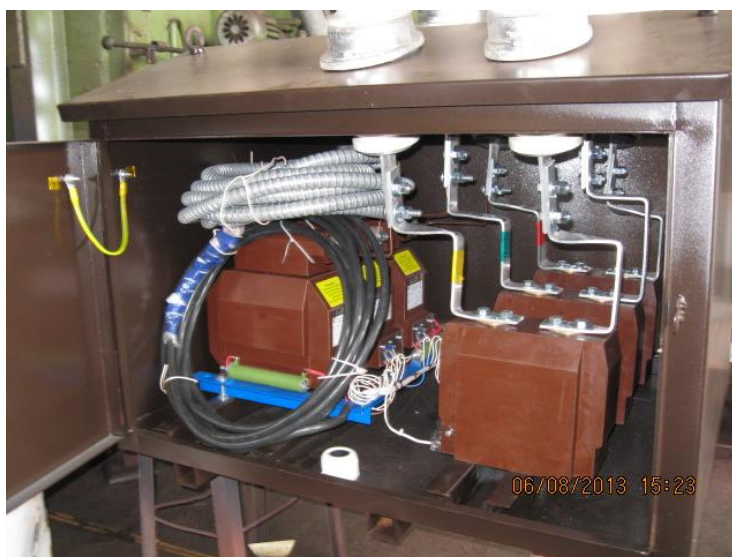
Фото 2. Пункт коммерческого учета электроэнергии типа ПКУЭ сх.3ТТ+3ТН
