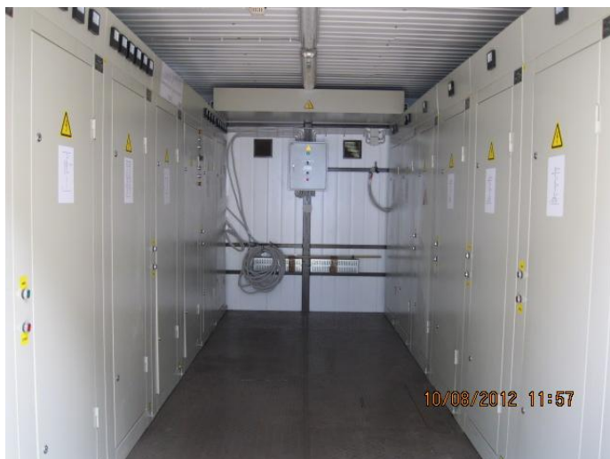
Фото 6. Распредустройство 0,4 кВ в 2КТПНУ-1000 ООО «ФорумТверь», ТПЗ Боровлёво, г.Тверь
